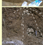
Der geologische Schurf beim Donnerloch #1 demonstriert den heftigen Schock von unten. a = die Perforation der Nagelfluhplatte; b = Intrusion von sandig-kiesigem Material; c = Aufweilung der hangenden Schichten; d = aus der Nagelfluhplatte herausgebrochene und hochgedrückte Nagelfluhbrocken.
